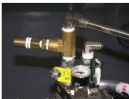
Foto 1: valvola di sicurezza e manometro su contenitore criogeno.
